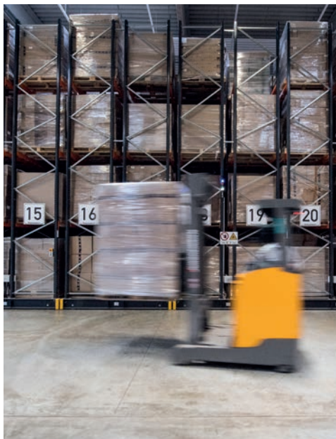
Befestigung von Regalfüßen in Hochregal- lagern
